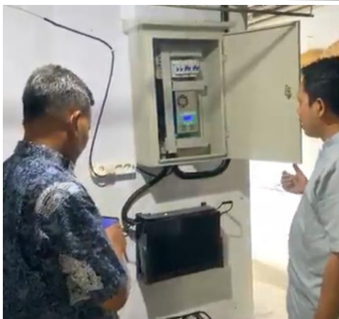
Gambar 6. Sistem Instalasi PLTS
